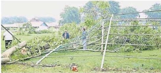
大树倒下后，操场的防护网墙也被压毁。
